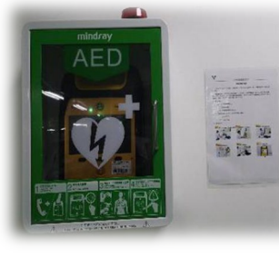
车间配备的 AED 设备
