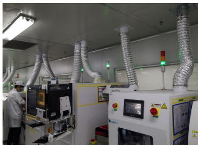
SMT 废气排放管
