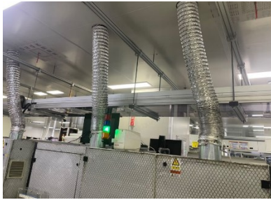
回流焊废气排放
