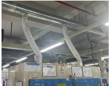
烤箱废气排放管
