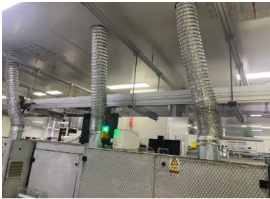
回流焊废气排放
