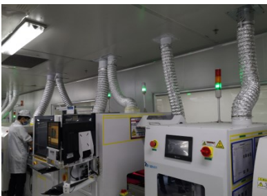
SMT 废气排放管
